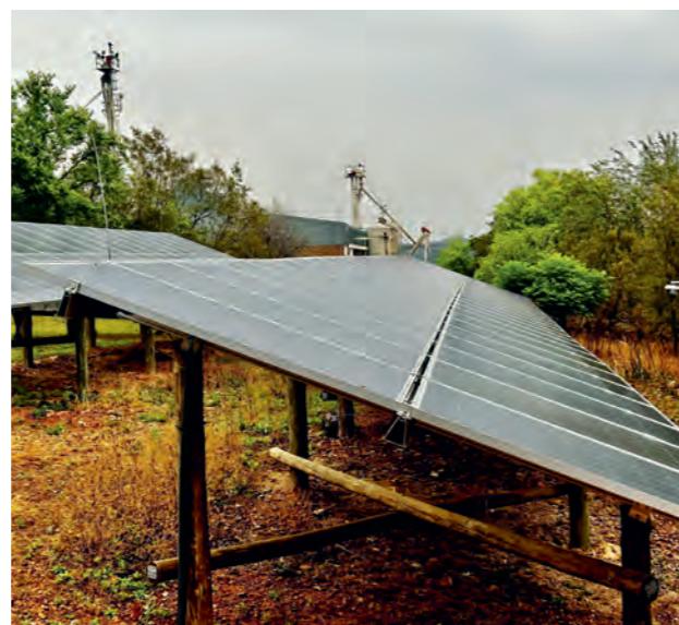
Solaranlage auf einem landwirtschaftlichen Betrieb in der bayerischen Partnerprovinz Westkap. Deutschland unterstützt Südafrikas Energiewende mit über 1 Milliarde Euro. Die meisten Mittel werden als Kredite zur Verfügung gestellt, beispielsweise zum Netzausbau.
